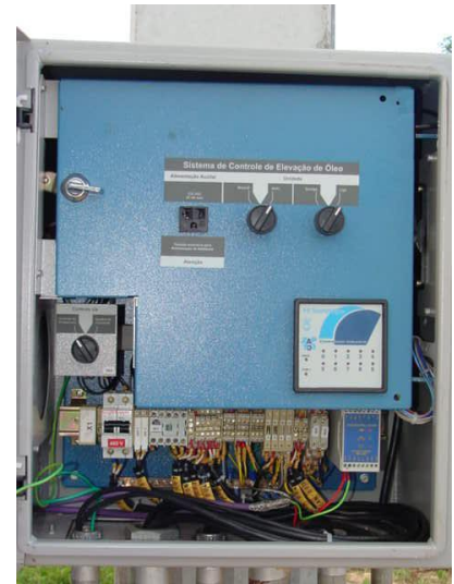
Figura 2.7: Armário de um poço BCP automatizado.
