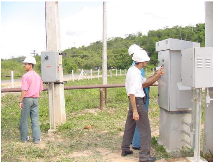
Figura 2.6: Local de um poço BCP automatizado.
