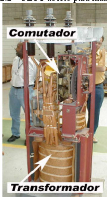
Figura 2.2 - OLTC aberto para manutenção
