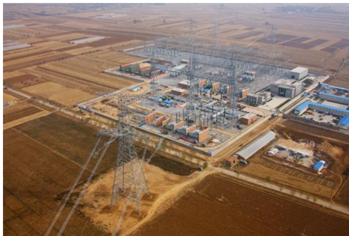
Figura 3. Subestação do sistema piloto de 1100 kV na China
