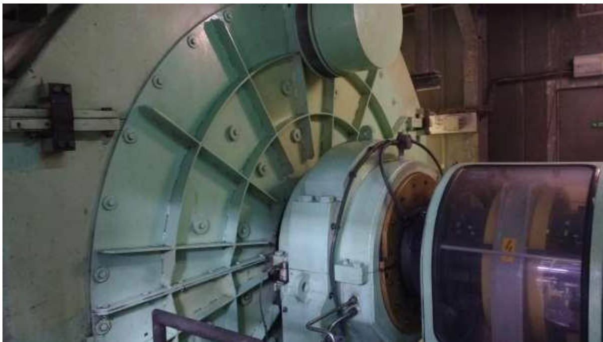
Figura 15 - Tampas do gerador Lado-Não-Acoplado (LNA).
