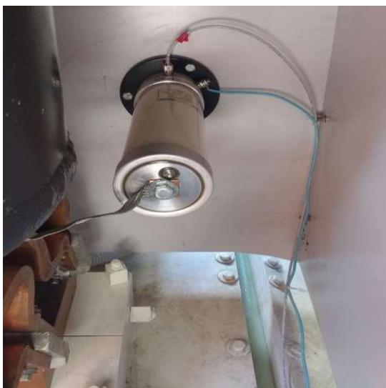
Figura 16 - Capacitor instalado por link flexível à conexão de saída do gerador com o duto de barras.
