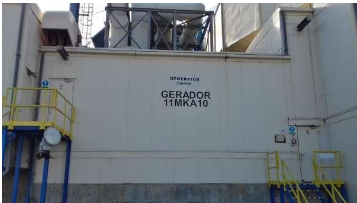
Figura 13 - Enclausuramento do Gerador.
