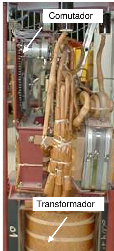
Figura 2.3: Regulador aberto para manutenção.
